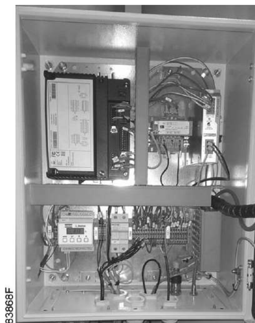
Внутри шкафа управления
