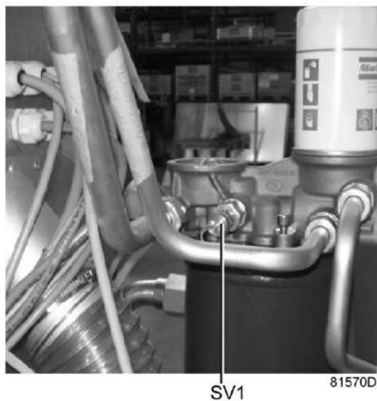
Предохранительный клапан резервуара маслоотделителя
