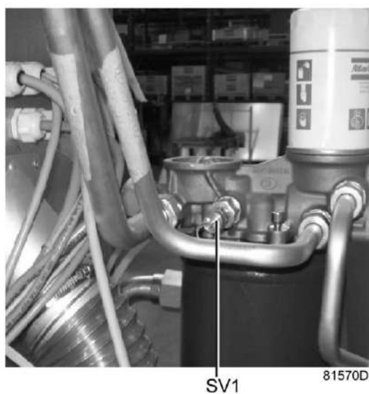
Предохранительный клапан резервуара маслоотделителя
